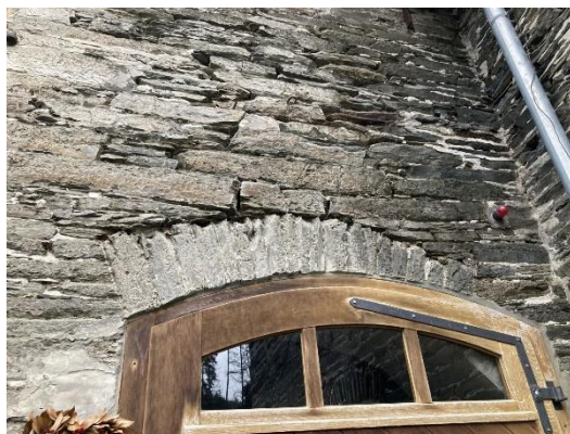
Abb. 14 Spalten in der Bruchsteinwand.
