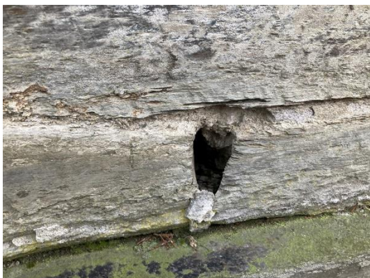
Abb. 13 Höhlung in der Bruchsteinwand.
