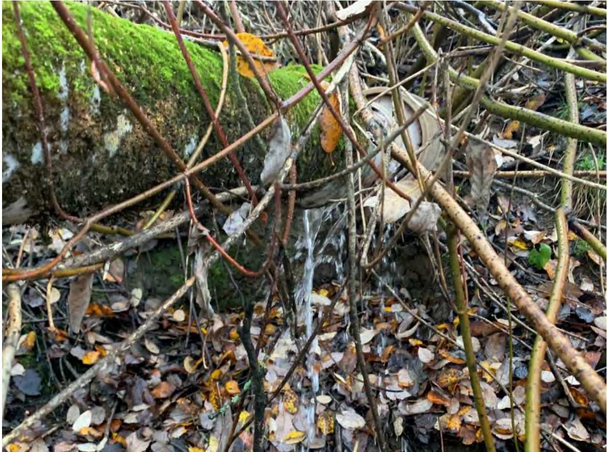
Abbildung 1: Maroder Rohrleitungsabschlag aus der Kleinen Gebke in das Vorbecken (Foto vom 02.12.2019).
