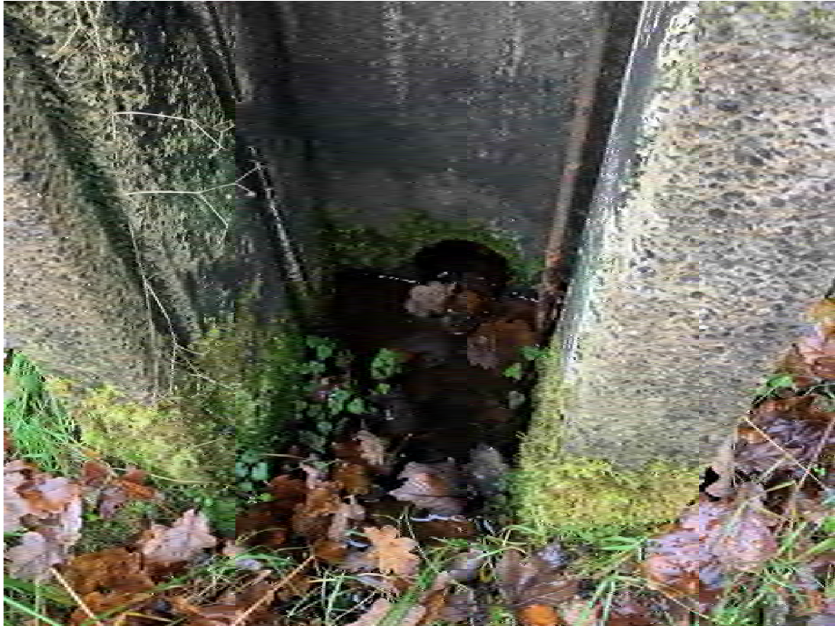
Abbildung 3: Bodennah geöffneter und nicht mehr funktionsfähiger Mönch am Vorbecken (Foto vom 02.12.2019).
